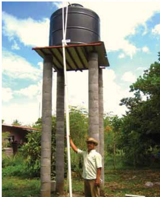
Foto 34. Tanque de almacenamiento para el acueducto ganadero Foto: Andrés Zuluaga.
